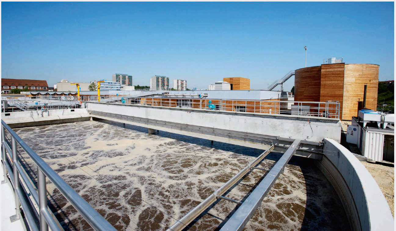
Fig. 9 Blick auf die SBR-Anlage und die Schlammbehandlung
