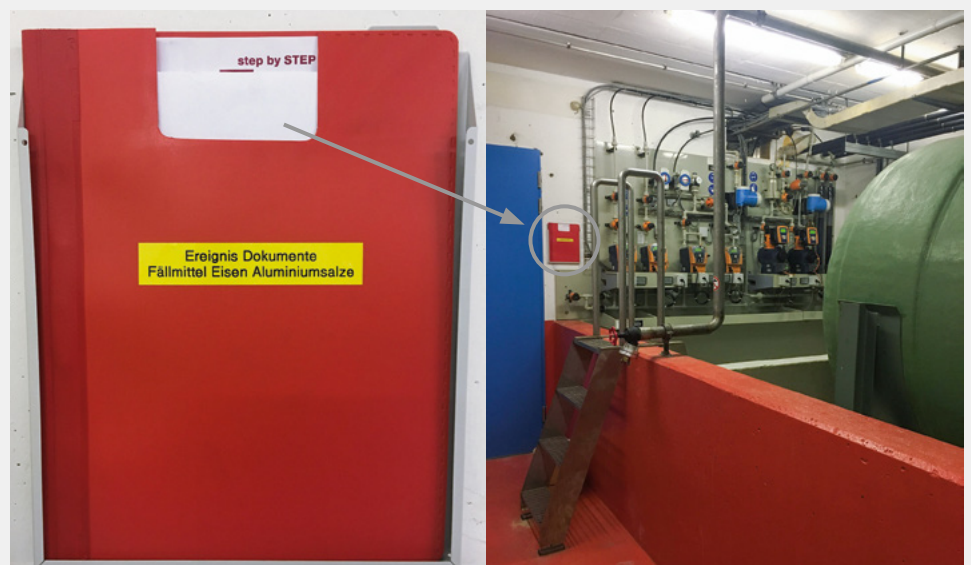
Fig. 1 Stets griffbereit: Step-by-STEP-Notfallmappe mit allen notwendigen Formularen und Plänen (links) und Eisenfällmittelstation mit Notfallmappe (rechts).
